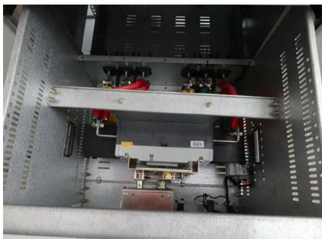
出线 9 抽屉照片
