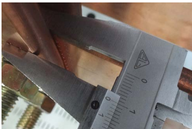
主开关进出线母排厚度照片
