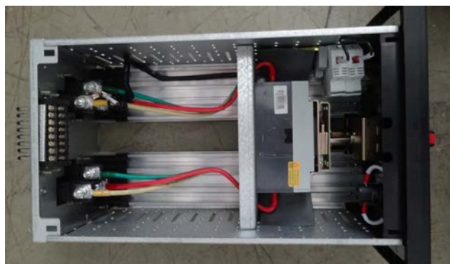
出线 1 抽屉照片
