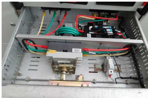
出线 6 抽屉照片
