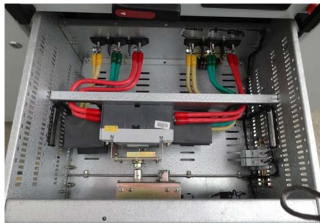
出线 8 抽屉照片
