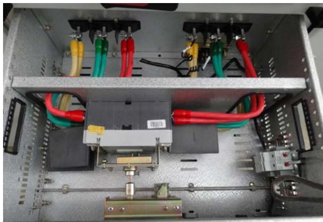
出线 7 抽屉照片
